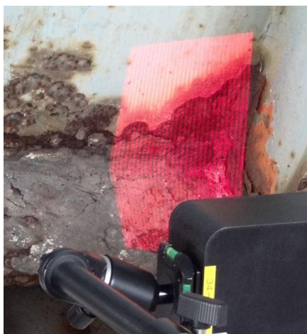
第1図 隅肉溶接部の腐食計測
