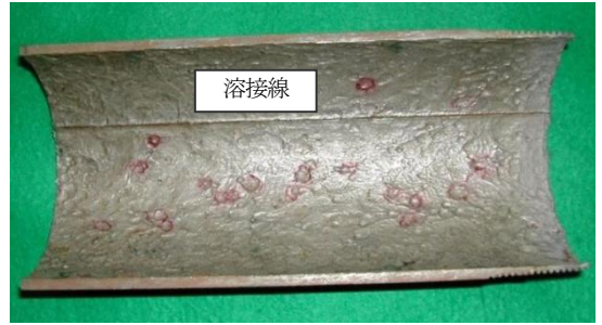
第10図 炭素鋼配管内部
