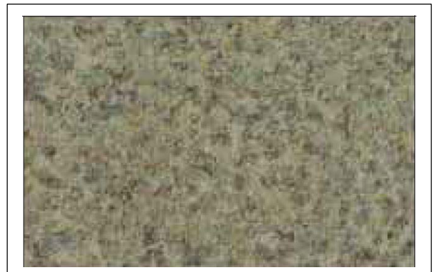
図1 耐候性鋼に発生したレベル3の腐食
