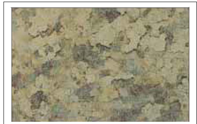
図2 耐候性鋼に発生したレベル2の腐食
