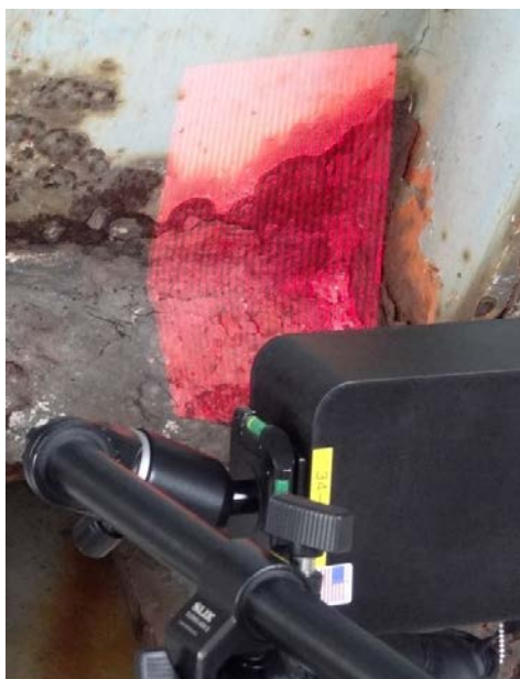
図 1 2. 隅肉溶接部の腐食計測
